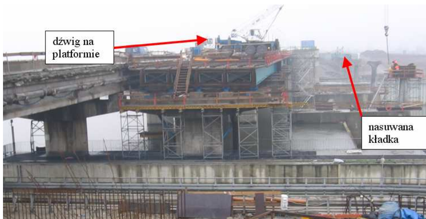
Rys. 12. Widok ogólny przebudowy konstrukcji ustroju nośnego - budowa podpór kładki z wykorzystaniem dźwigu na prefabrykatakach VFT.
